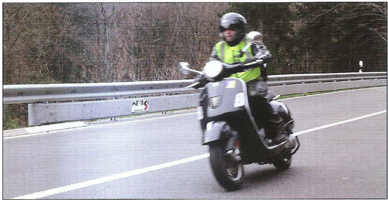
Unterfahrschutz auf der B48 in Rheinland-Pfalz – hier fährt gerade Marcus Pötschke vom VFCD an der neuen Sicherheitseinrichtung vorbei. Fotos: Sigrid Bödicker
