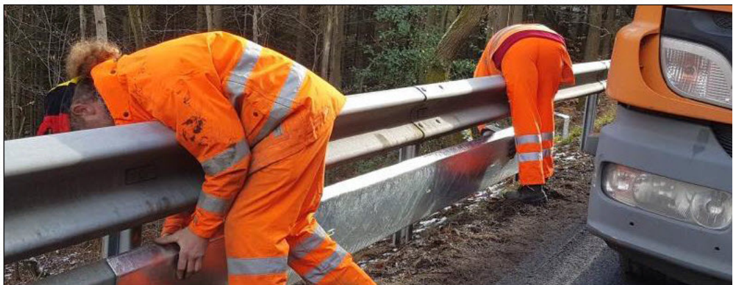
Straßenwärter montieren den Unterfahrschutz an der Landesstraße zwischen Ahrweiler und Ramersbach an den Planken.
